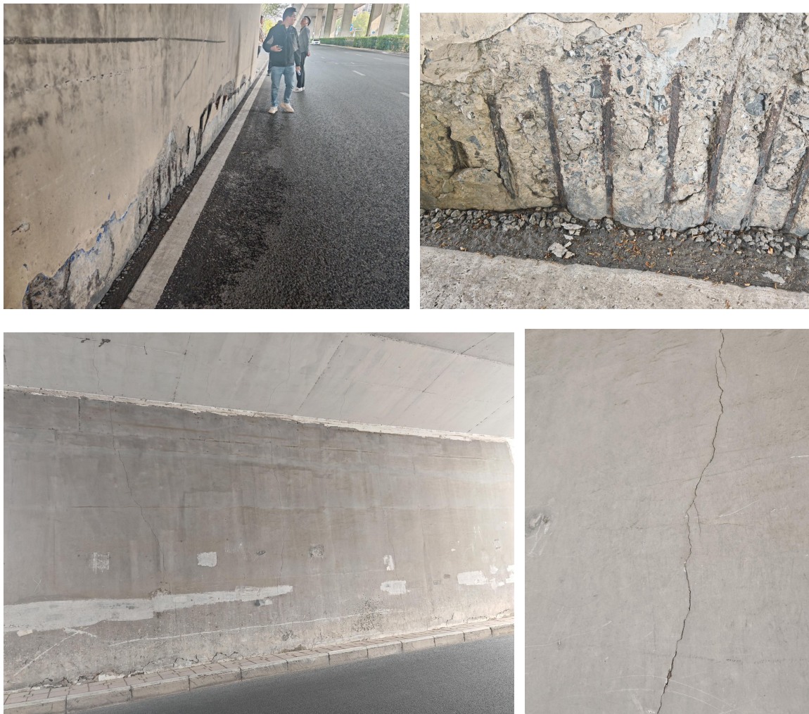
图 3.2 既有立交桥混凝土缺损、开裂现状
